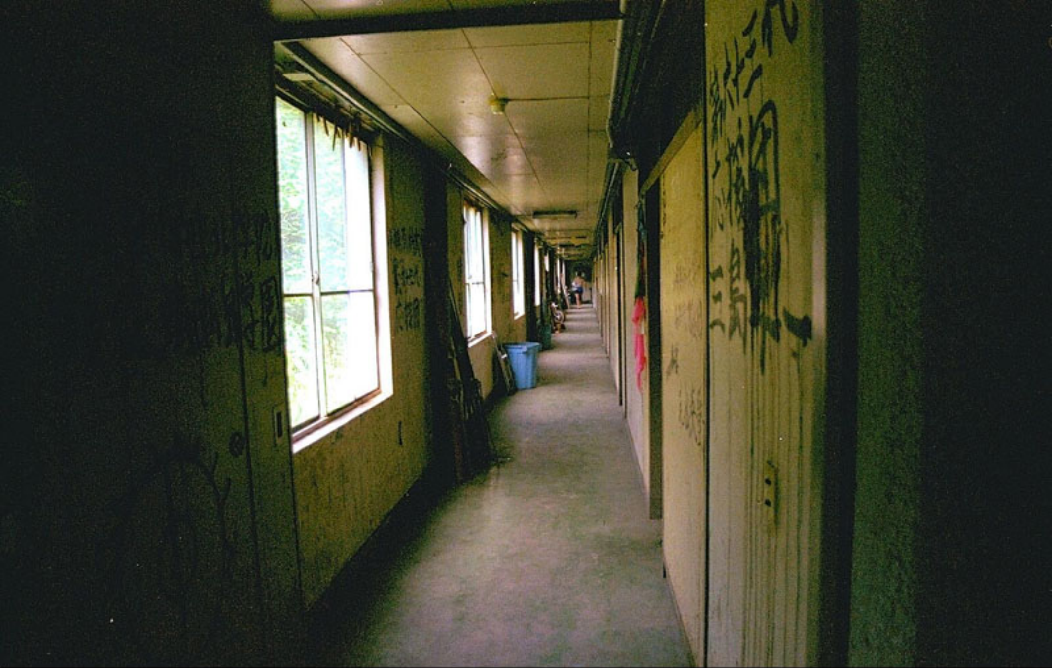
新棟、旧棟の接続部分から旧棟の廊下。暗く写っていてこれ以上補正出来ませんでした。手前3室は応援団室です。
